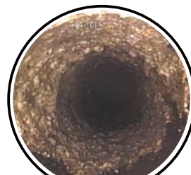
▲油が付着した排水管
