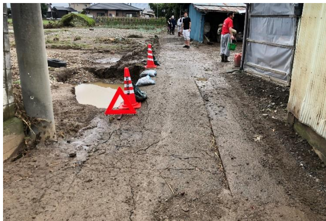
並木町（市道2級131号線：河川氾濫による土砂堆積・流失） 復旧前
