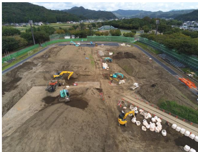
集積された土砂の処理作業の様子 (戸室町：田沼グリーンスポーツセンター多目的競技場)
