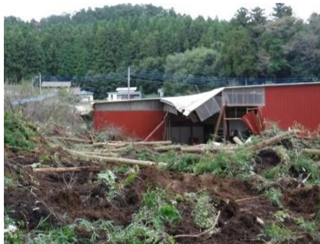
土砂崩れの被害を受けた自動車修理工場 (豊代町)
