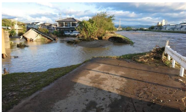
大橋町（秋山川：大橋北決壊箇所） 復旧前
