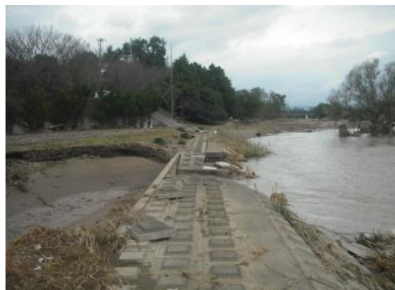
護岸が浸食された旗川 旗川橋付近(小中町)
