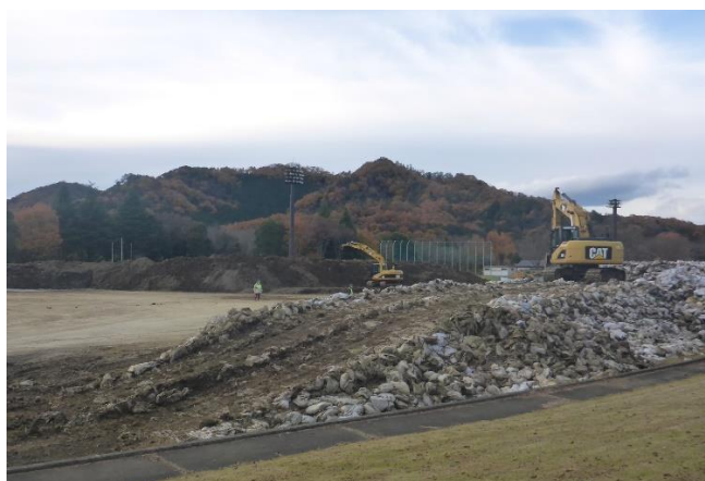
戸室町（田沼グリーンスポーツセンター 多目的競技場：堆積土砂仮置場） 復旧前
