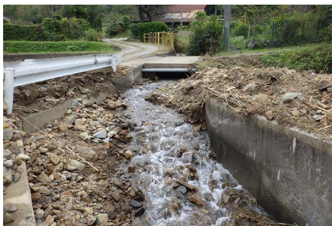
会沢町（坂の沢：土石流による土砂堆積） 復旧前
