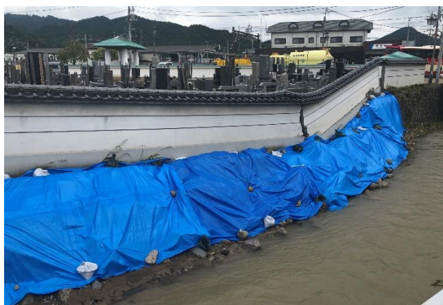
葛生東（小曾戸川：河川氾濫による護岸洗堀・崩落） 復旧前
