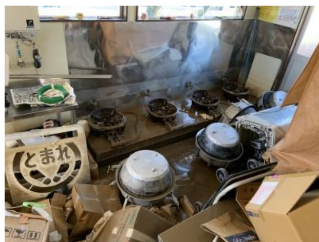
施設内が浸水し施設が損壊した 大橋町東部集会所（大橋町）
