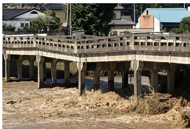
多田町（安蘇川橋：河川氾濫による崩落） 復旧前
