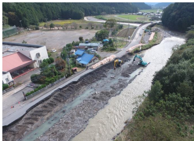
洗掘により崩落した県道秋山葛生線（水木町）
