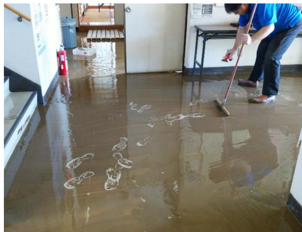
施設内が浸水し土砂が堆積した隣保館（赤坂町）
