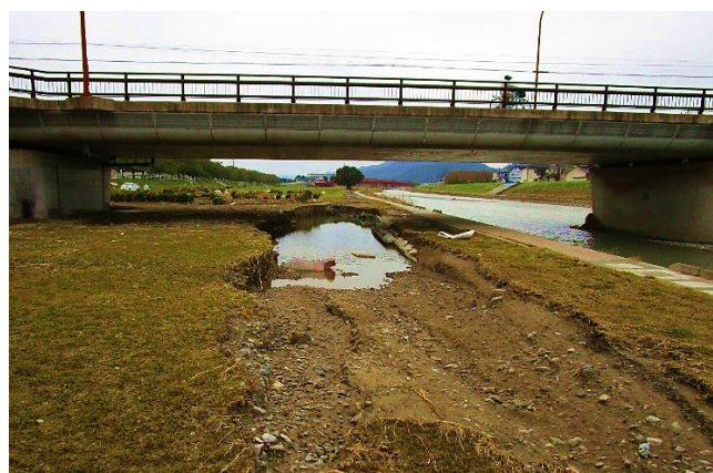
堀米町（秋山川堀米緑地右岸：河川氾濫による敷地内洗堀） 復旧前
