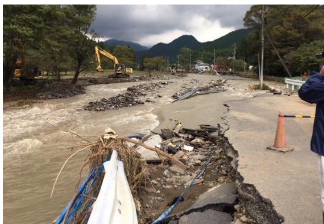
水木町（県道秋山葛生線：河川氾濫による道路洗掘・流失） 復旧前
