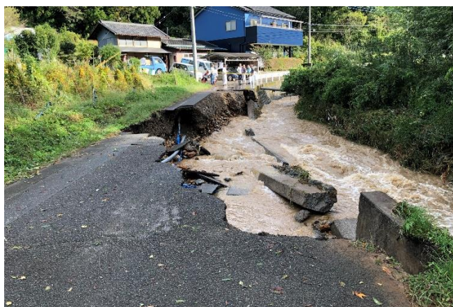
御神楽町（市道221号線：河川氾濫による洗堀・流失） 復旧前
