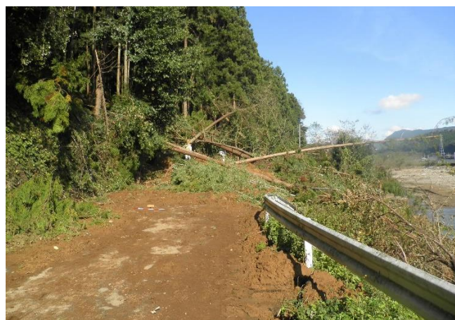
豊代町（市道大久保下川線：土砂崩れによる 土砂堆積・道路崩落） 復旧前
