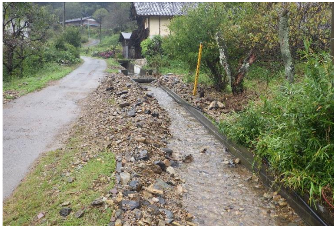
下彦間町（家隆沢：土石流による土砂堆積） 復旧前
