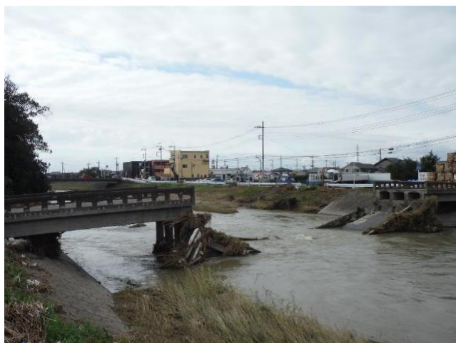
崩落した中橋（大橋町）
