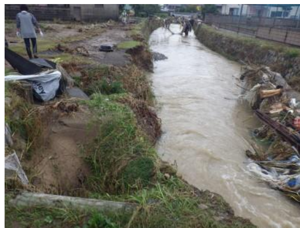
溢水・洗掘等の被害が発生した小曾戸川 (葛生東一丁目)
