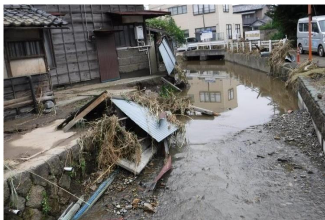
田島町（菊沢川：氾濫による護岸浸食） 復旧前
