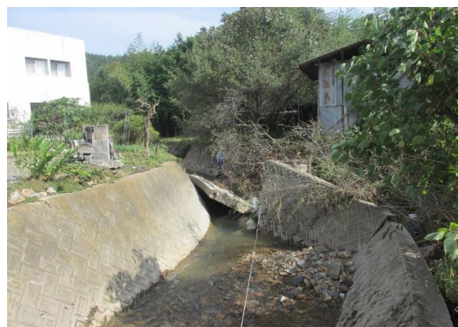
岩崎町（岩崎川：河川浸食による洗堀・護岸崩落） 復旧前
