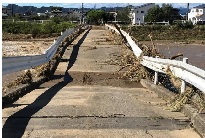
田之入町（田之入橋：河川氾濫による崩落） 復旧前
