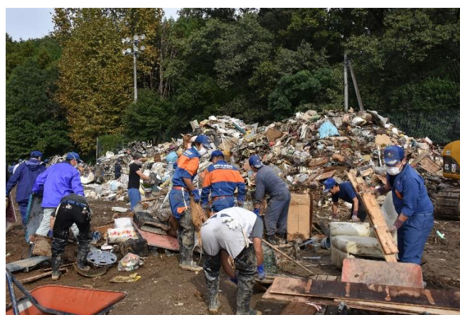
田沼町（田沼総合運動場野球場：災害ごみ仮置場） 復旧前
