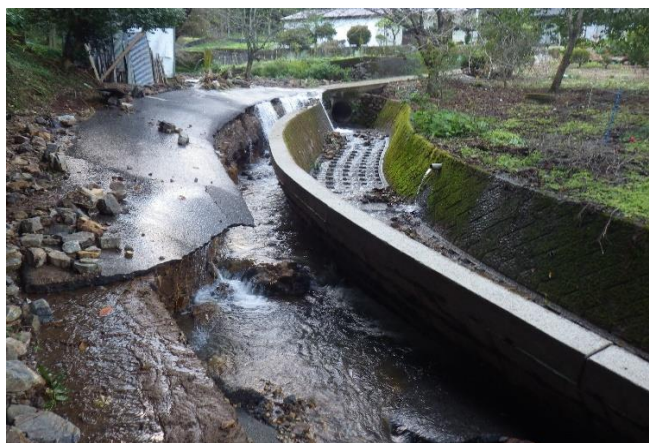
梅園町（西ノ入沢：河川氾濫による洗堀・流失） 復旧前
