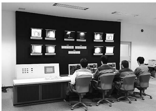
みかもクリーンセンター中央制御室
