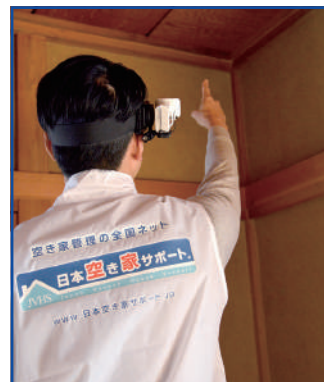
雨漏り・カビ確認
