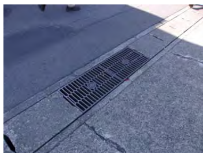
路側帯にある旧型グレーチング
