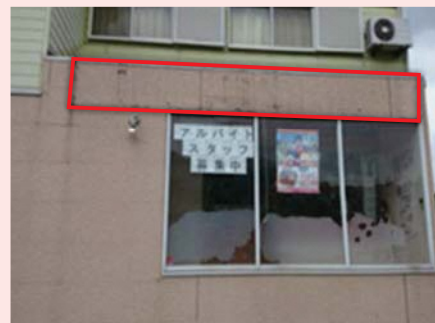
落下した後の壁面
