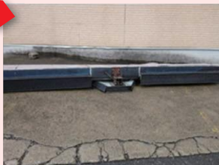
落下した欄間看板
