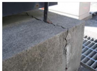
看板基礎のひび割れ
