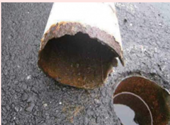
ポールの根腐れによる倒壊
