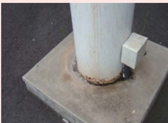
ポールの根元にサビが発生
