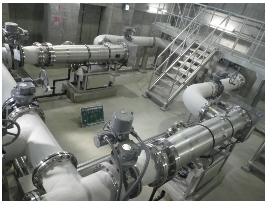
写真 大橋浄水場紫外線照射装置
