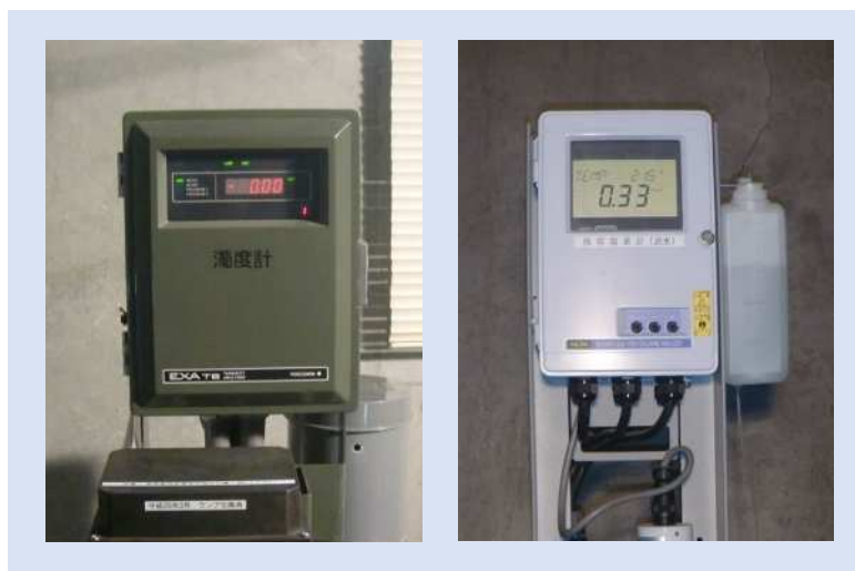
図 5-2 自動水質監視装置（左図：濁度計、右図：残留塩素計）
