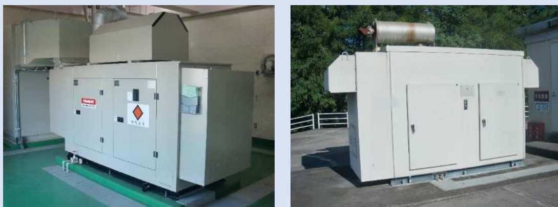
図 5-9 非常用発電装置
