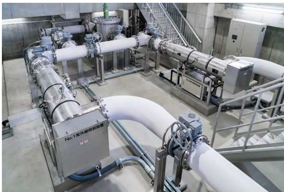
図 7-1 大橋浄水場 紫外線照射装置
