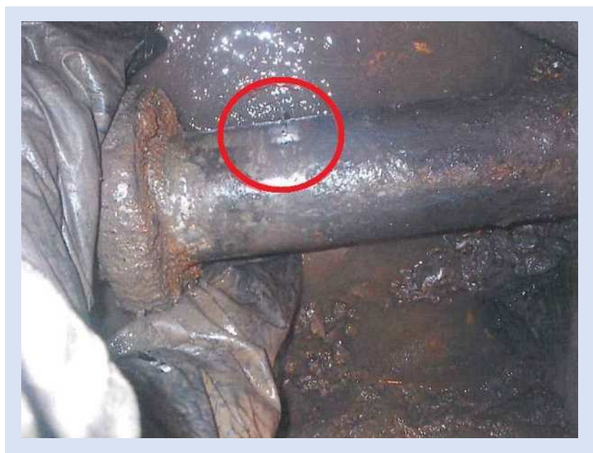
図 5-16 漏水事故の様子
