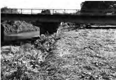
▲土砂や雑木などが堆積している寺並橋付近の様子
