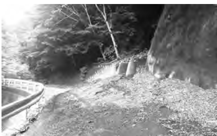
▲ 作原沢入線の土砂流出箇所
