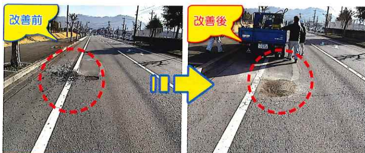
道路（市道）に穴が空いているので改善して欲しい。 新都市中央公園前の道路に穴が空いており危ないので直して欲しいとのお話がありました。 → 市の道路河川課に要望し補修をしていただきました。
