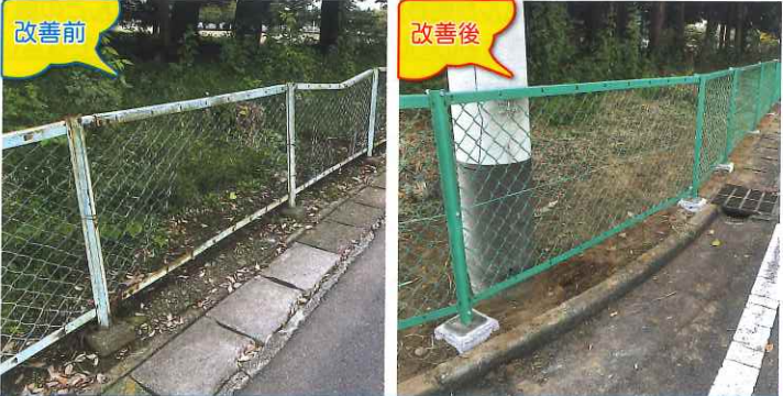
あぶつか公園のフェンスが老朽化しているので改善して欲しい。 あぶつか公園のフェンスが老朽化(変形や穴があいている)ので、公園全体のフェンスを点検し改善をして欲しいとの声がありました。 → 佐野市の都市整備課に要望し、公園全体のフェンス点検をしていただき老朽化した北側のフェンスを新しくしていただきました。
