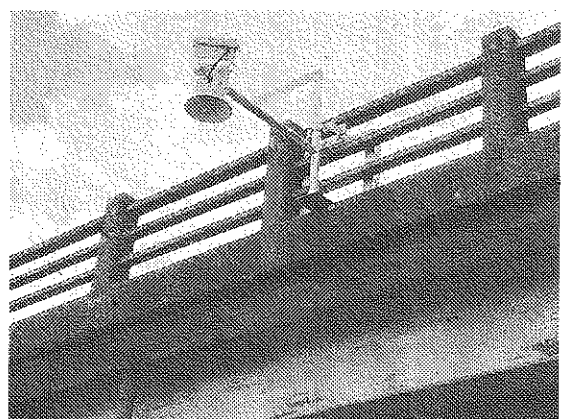
稲岡橋水位観測機
