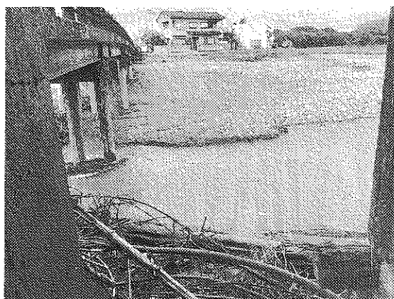
稲岡橋土砂体積状況
