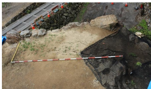
復元盛土の上面の亀裂(令和5年6月19日)
