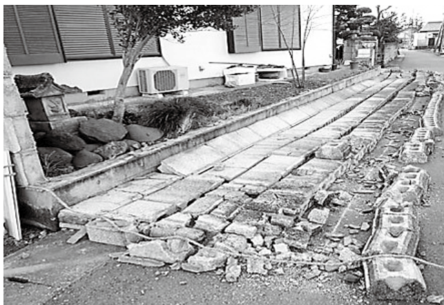
ブロック塀の倒壊
