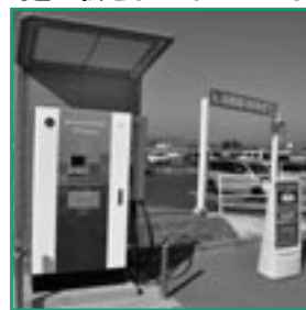
電気自動車 急速充電スタンド (道の駅どまんなかたぬま)
