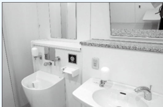
多目的トイレ(オストメイト)
